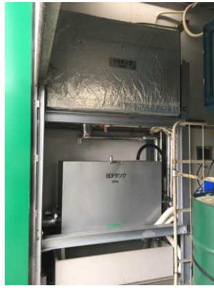
SV0 タンク・BDF タンク
